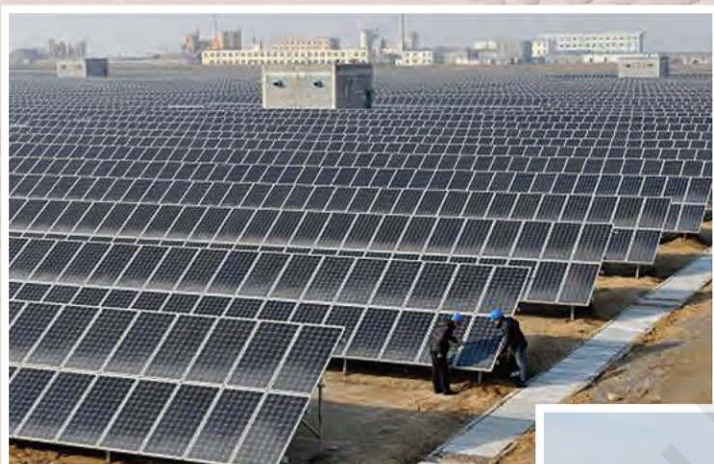
山东东营太阳能光伏电站
