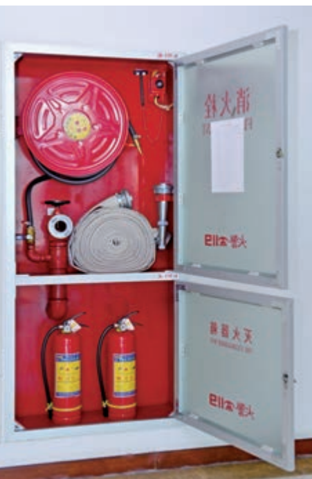
图7-10 建筑物内的消防设施
