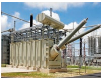
甲 变电站中的大型变压器
