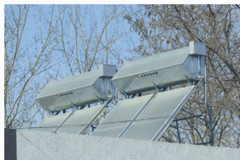
图 18.3-5 屋顶上的太阳能集热器为住户提供热水
