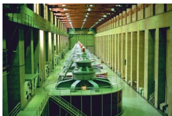
图16.4-4 现代水力发电厂中的发电机组
