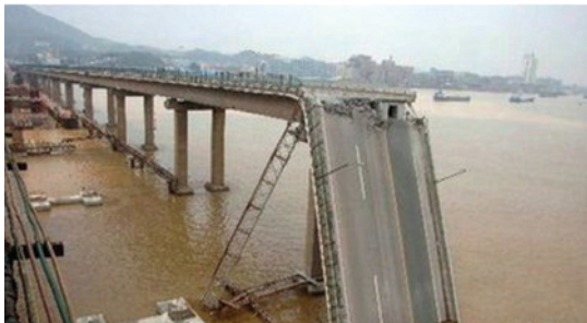
图 2.16 撞击后连续倒塌后的桥
